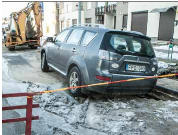
W Wilnie, na ulicy Lwowskiej, podczas silnych mrozów powstało nowe zapadlisko — przerwano dostarczanie wody Fot. ELTA
